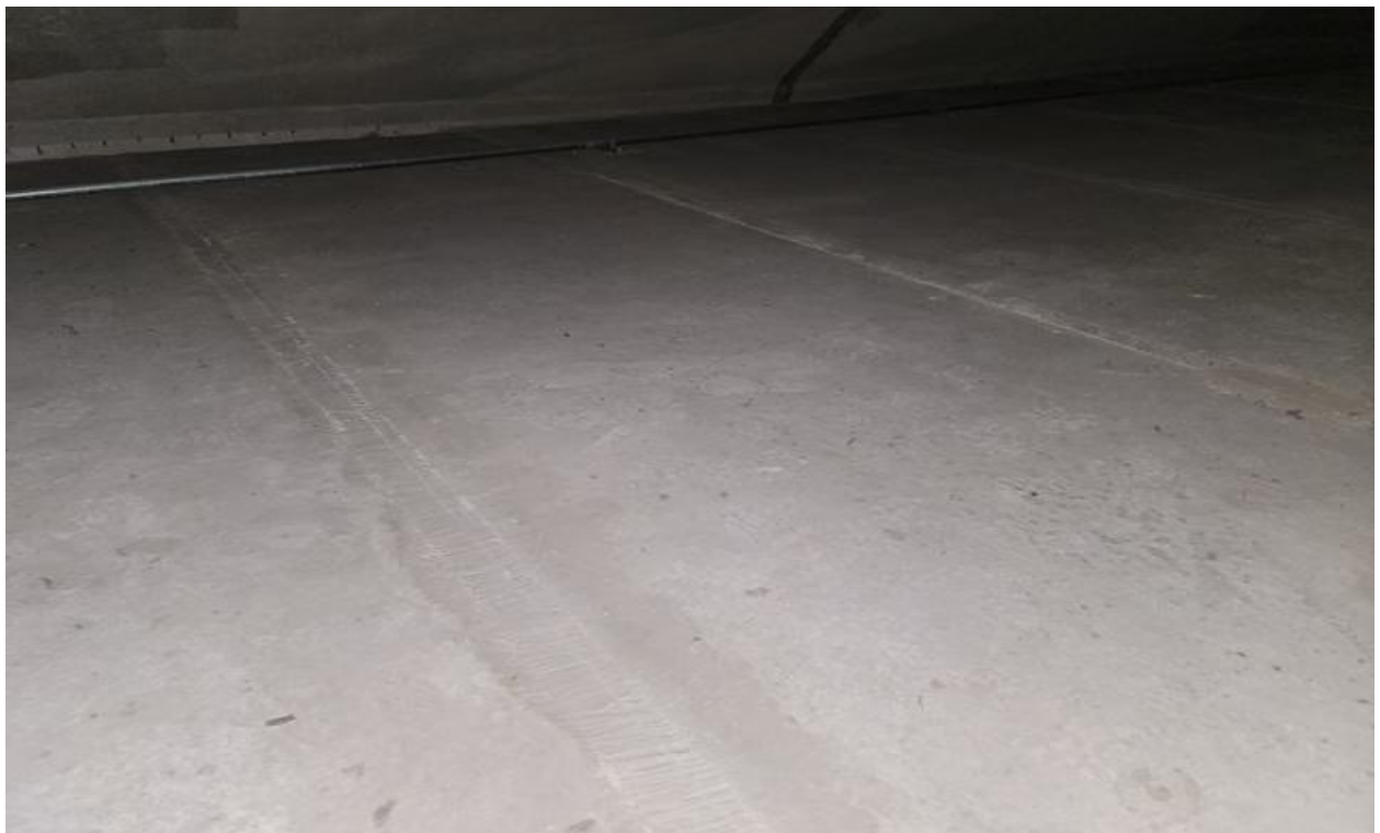
풍도슬래브 상면 S52 이음부 몰탈 파손
