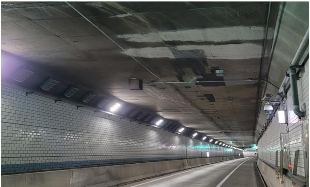
부대시설 S59 신호기 상태양호
