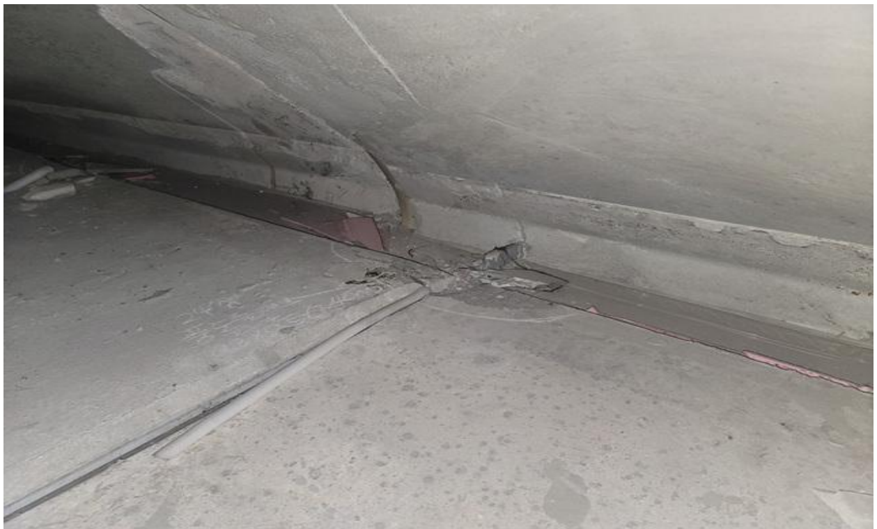
풍도슬래브 상면 S54 파손
