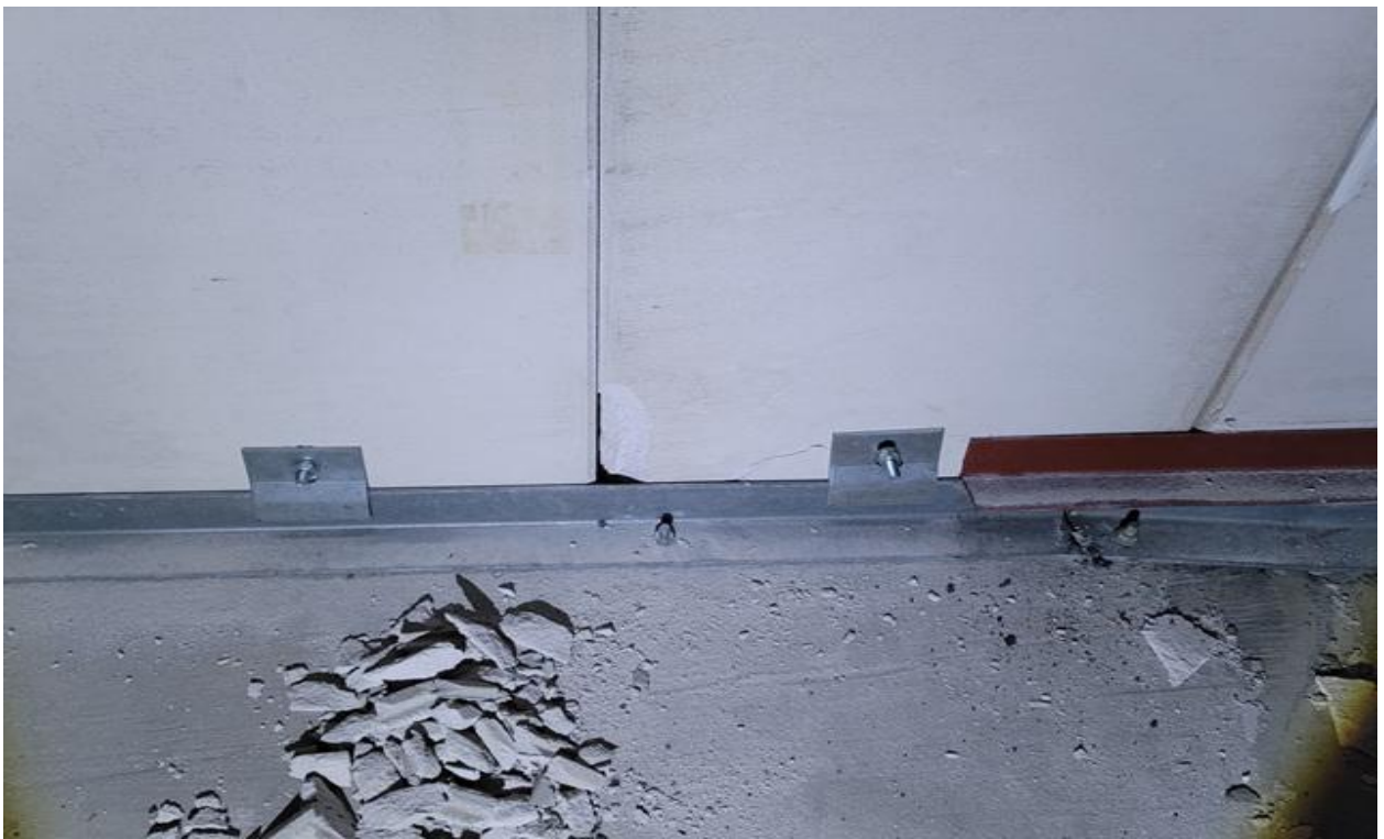
풍도슬래브 격벽 S54 파손
