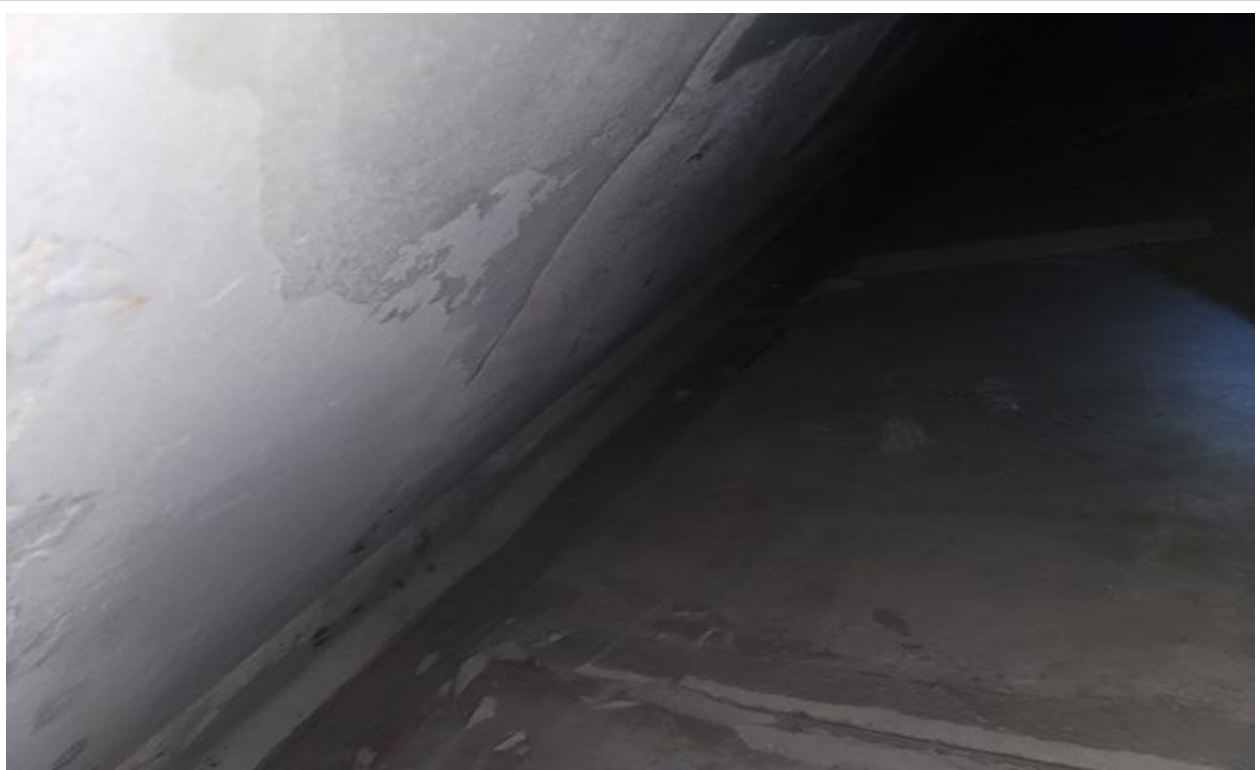
풍도슬래브 상면 S53 이음부 물탈파손
