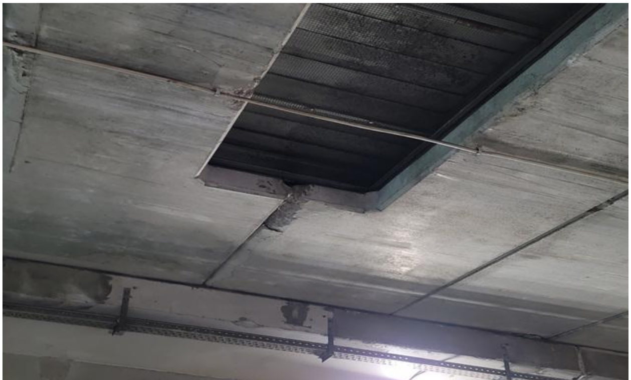
풍도슬래브 하면 S53 파손
