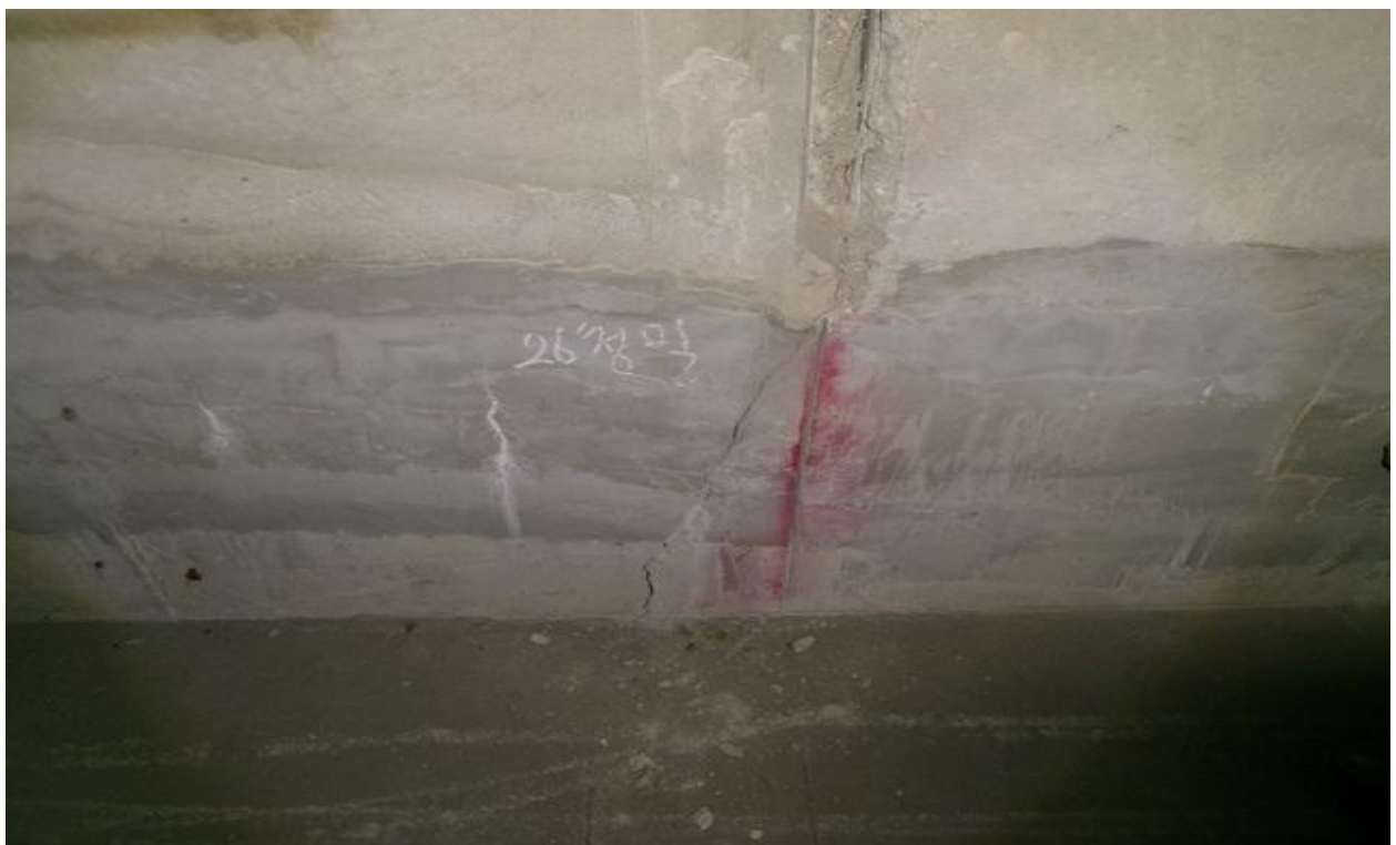
NATM구간 측벽부 S47 내부벽체 파손
