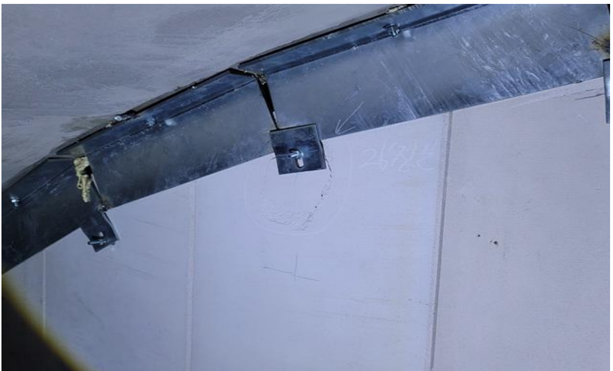
풍도슬래브 격벽 S54 파손
