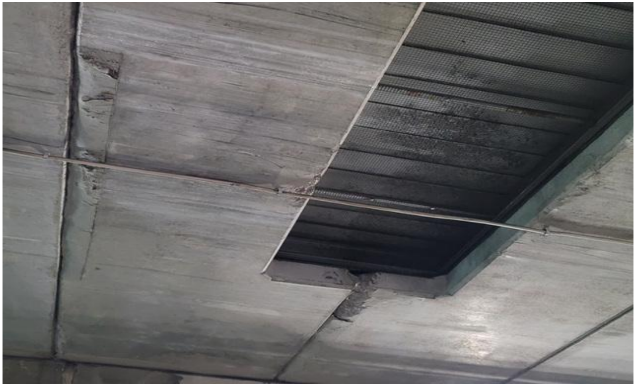
풍도슬래브 하면 S53 파손
