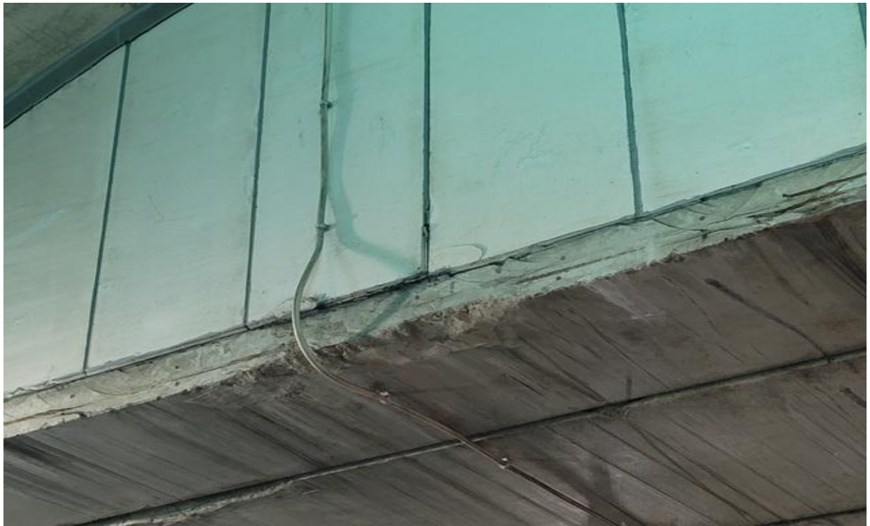
풍도슬래브 하면 S54 파손
