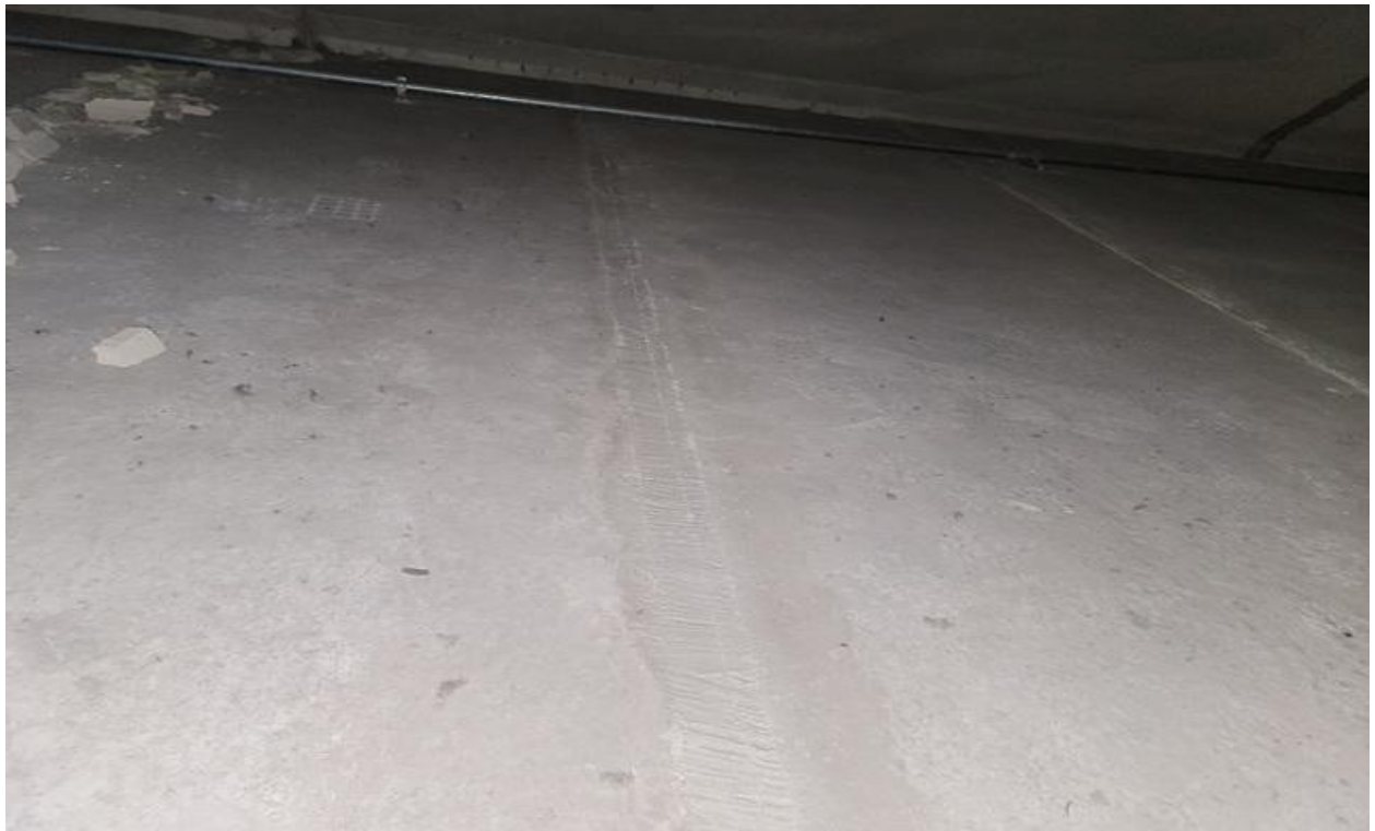
풍도슬래브 상면 S52 이음부 물탈 파손
