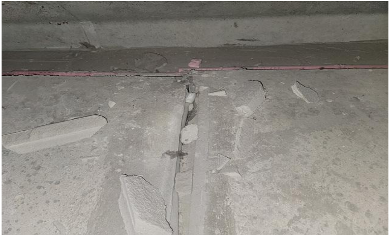
풍도슬래브 상면 S54 파손
