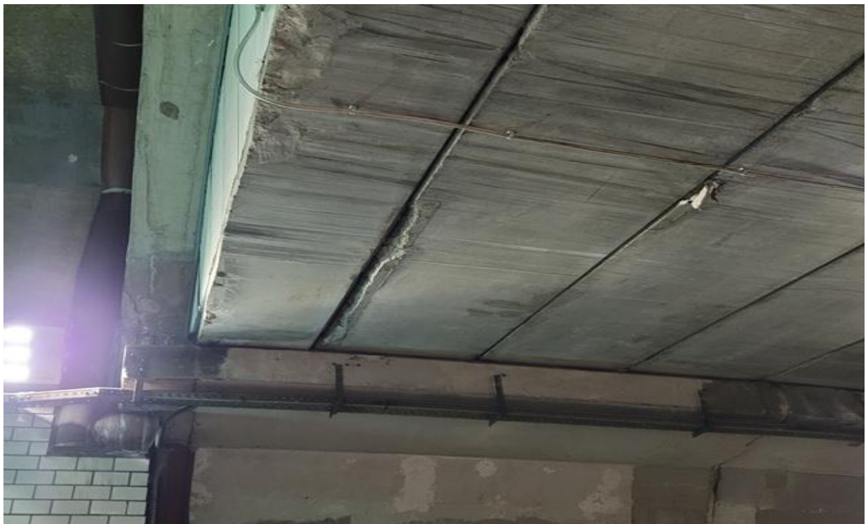
풍도슬래브 하면 S54 보수부 파손
