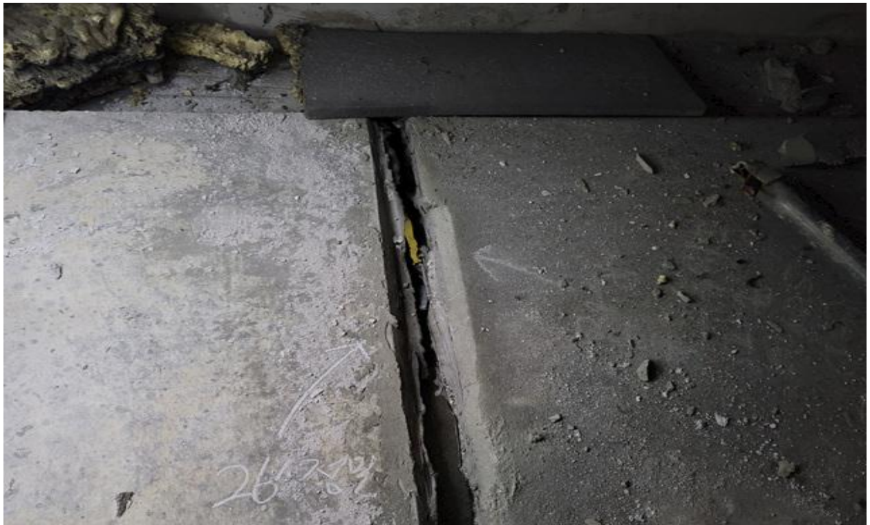
풍도슬래브 상면 S54 파손
