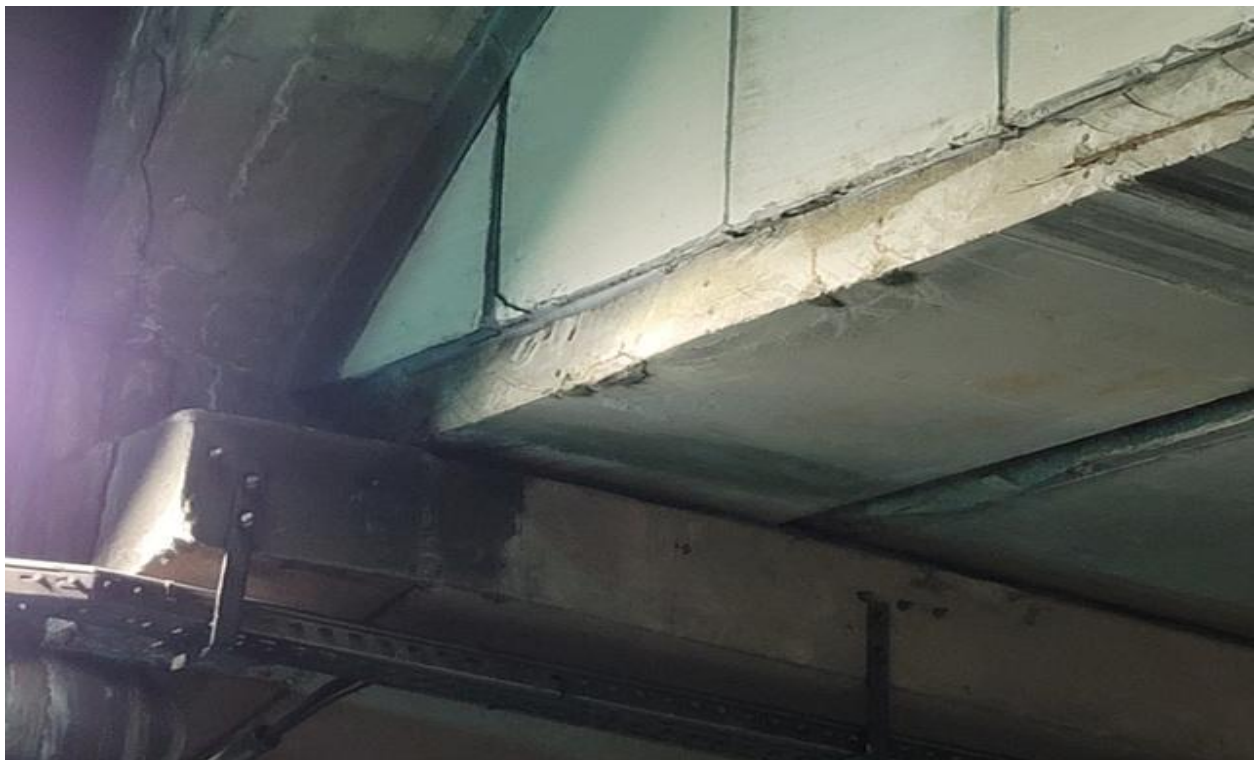
풍도슬래브 하면 S54 파손
