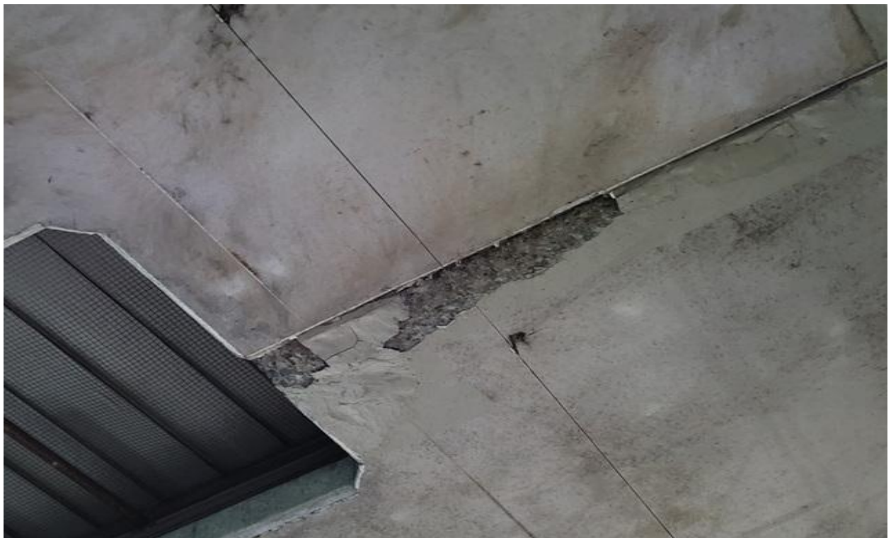
풍도슬래브 하면 S53 보수부 파손
