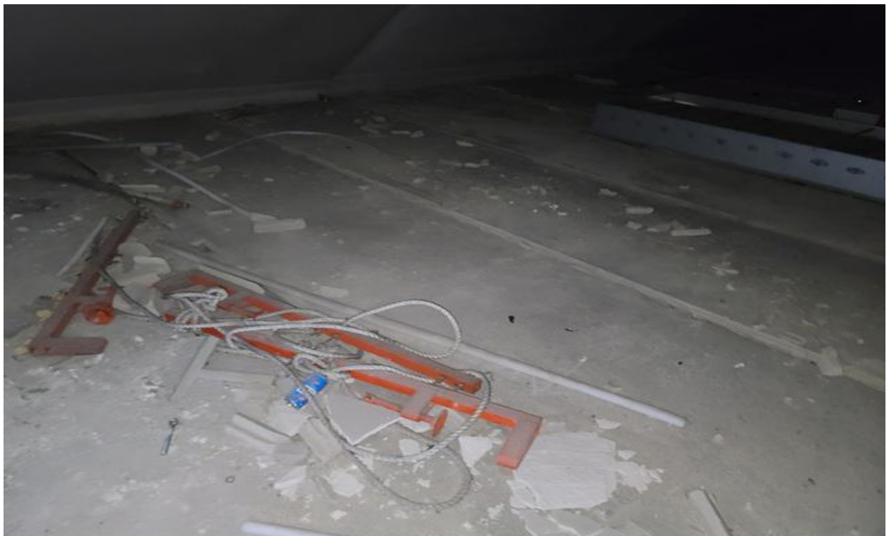
풍도슬래브 상면 S54 이음부 몰탈파손
