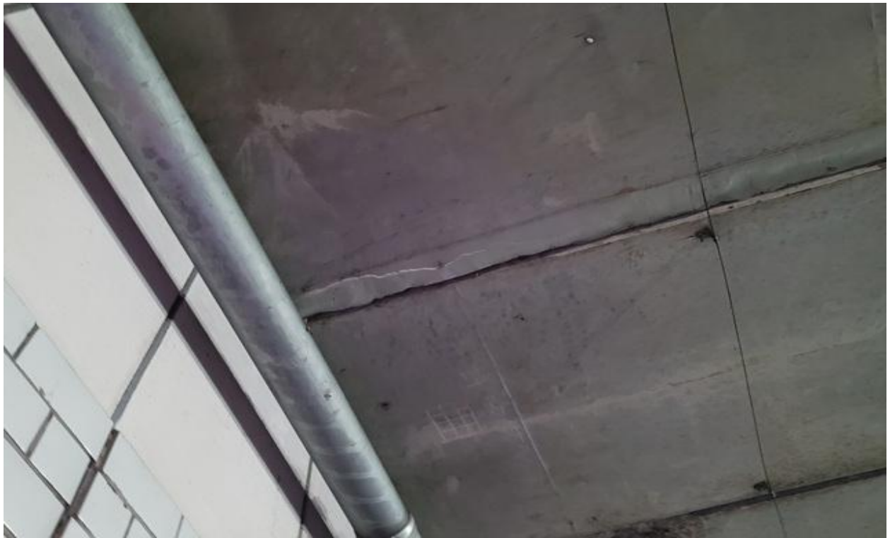
풍도슬래브 하면 S54 보수부 파손
